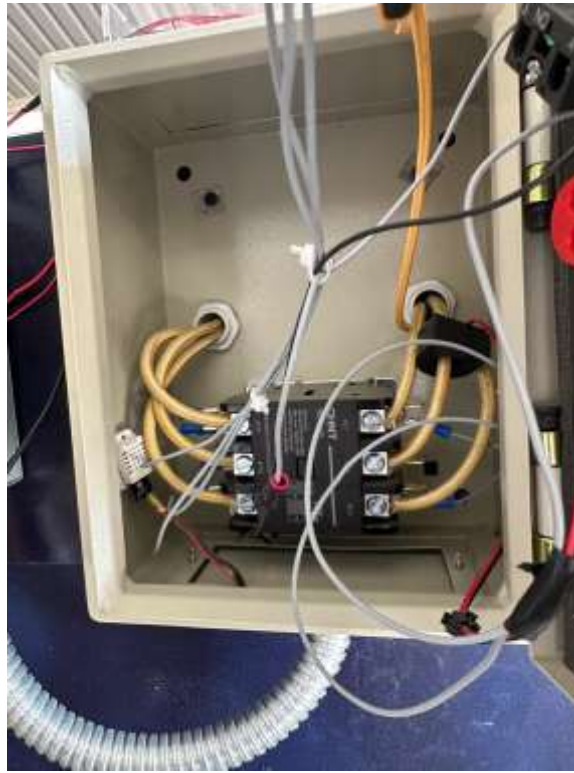
Figura 18. Adaptación del contacto en el tablero de control.
