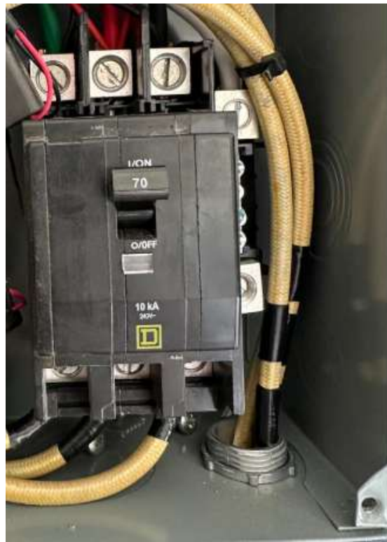
Figura 16. Integración del tablero de alimentación de potencia conectada a una suministración trifásica, los cables de asbesto (amarillos) son enviados directamente a la energía del control XMT-808.
