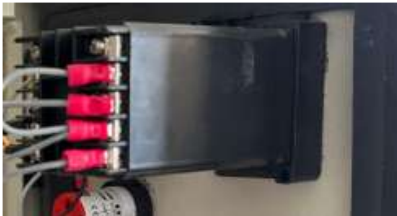
Figura 20. Panel de control empotrado al tablero.
